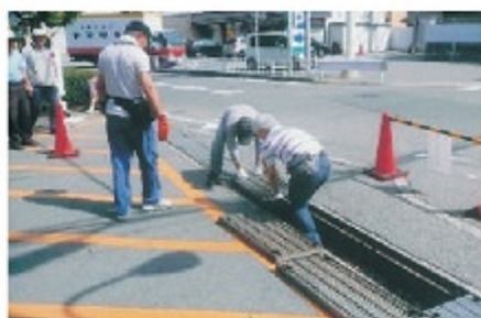
自動車の北側出入口の溝蓋
